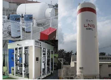
高圧ガスプラント設計施工 (出所) ナカテック HP より
